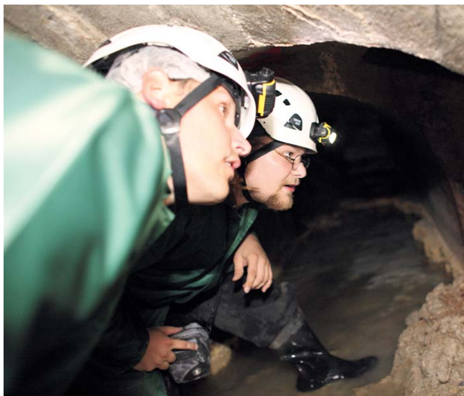
■ Kamil Tomek a starosta Vlastimil Gabrhel se v podzemí brodili vodou a častokrát se v úzkých chodbách pod nízkým stropem museli hodně ohnout. Foto: Zdeněk Dvořák
